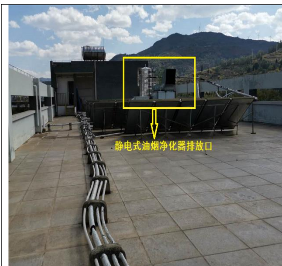
食堂楼顶油烟净化器
