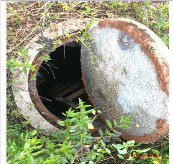
污水处理站进口
