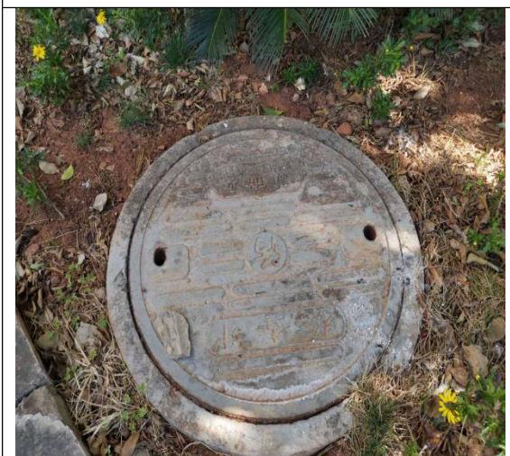
医院内部污水管网
