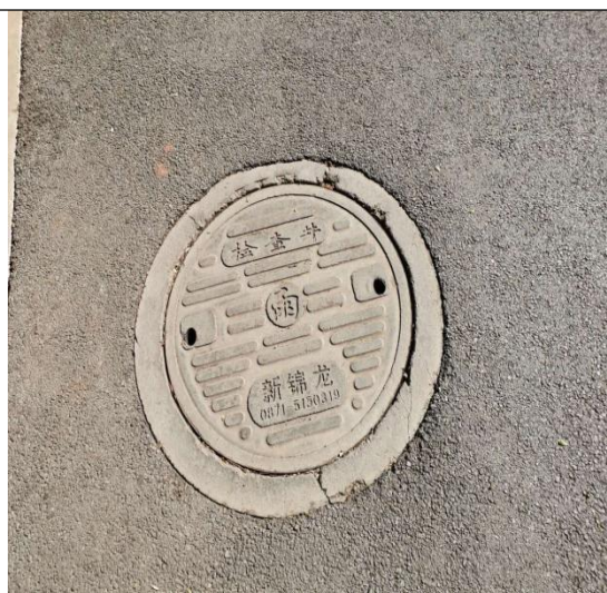
医院内部雨水管网
