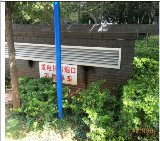
发电机排气口
