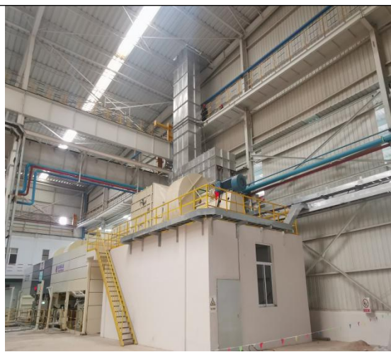
冷轧液高温挥发有机废气治理装置（油雾净化器）
