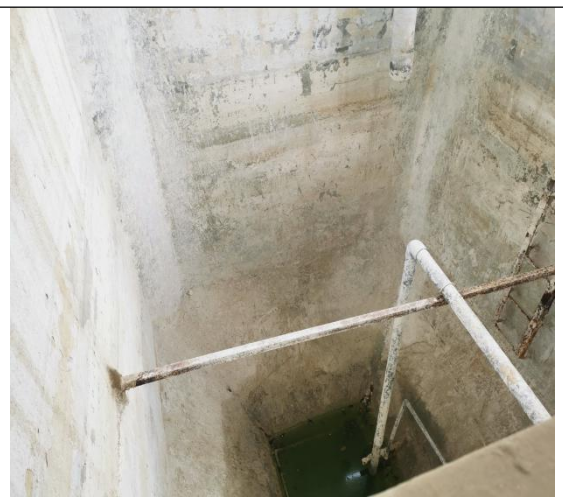
生产废水处理站回用水池
