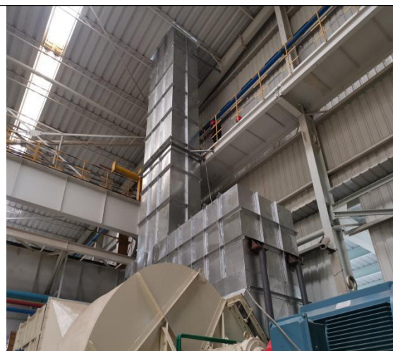
冷轧液风机排气筒（15m）
