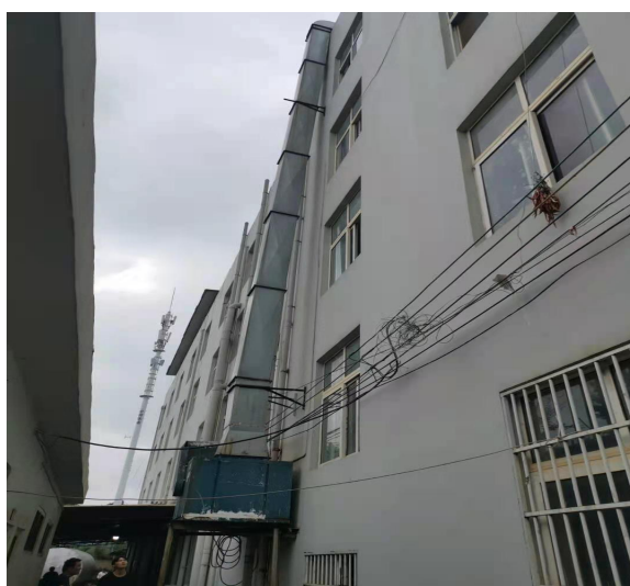
油烟净化装置排气筒
