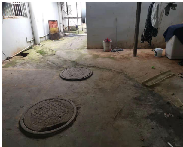
食堂隔油沉淀池(地埋式)
