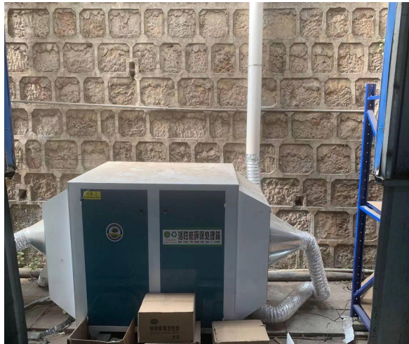
印染工序有机废气治理(活性炭吸附装置)
