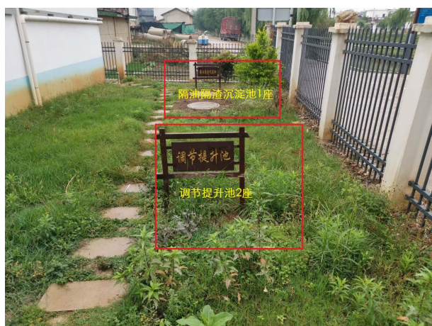
污水处理站→调节提升池（地埋式）
