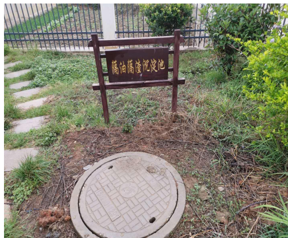
污水处理站→隔油沉渣池（地埋式）
