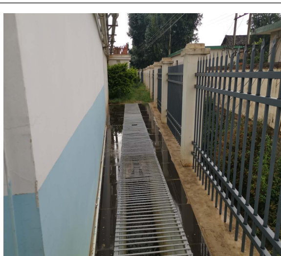
污水处理站进水口
