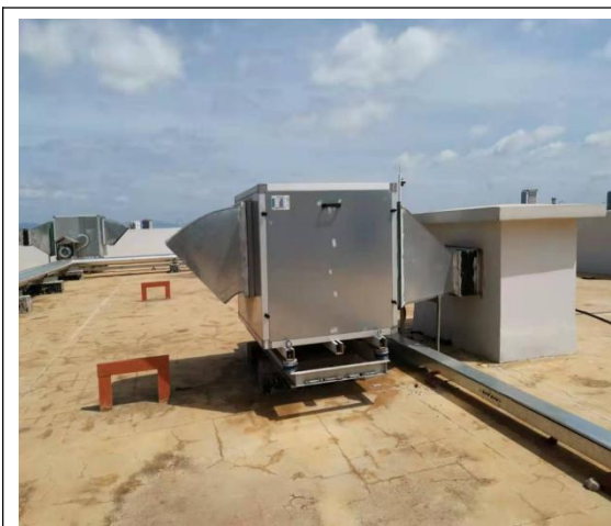
车间楼顶通风换气设备排口
