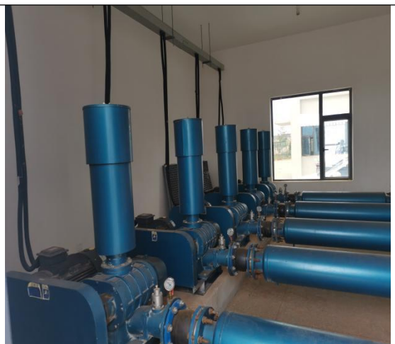
风机、提升泵房（密闭隔音）
