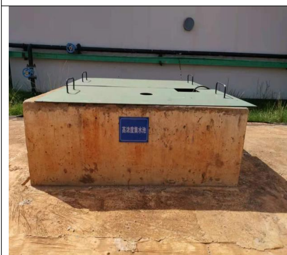
高浓度集水池（加盖）
