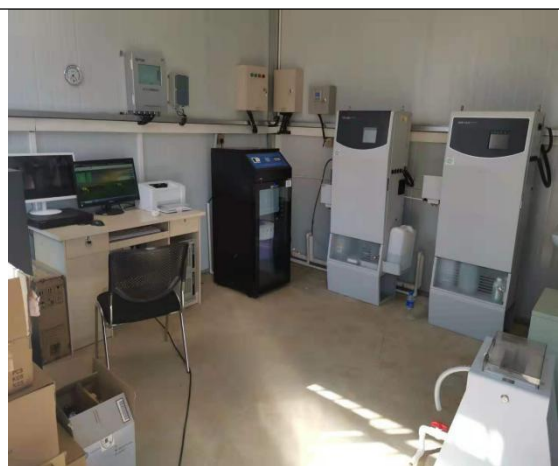
在线监测站房内部
