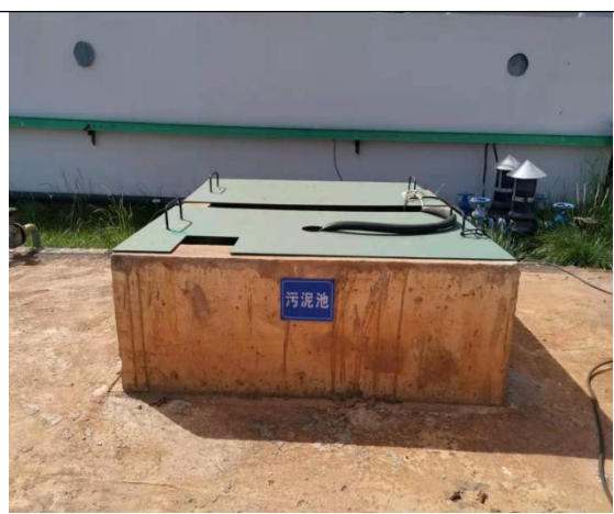
污水处理系统污泥池（加盖）
