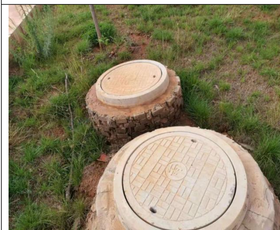
项目厂区雨水管网
