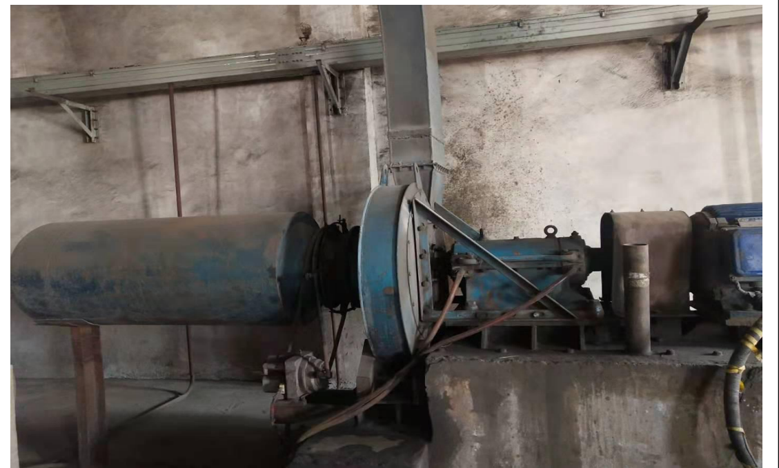
引风机加装消音器
