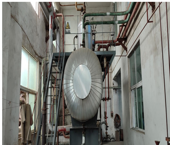
锅炉软水制备设备
