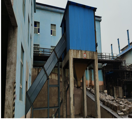
锅炉炉渣收集装置
