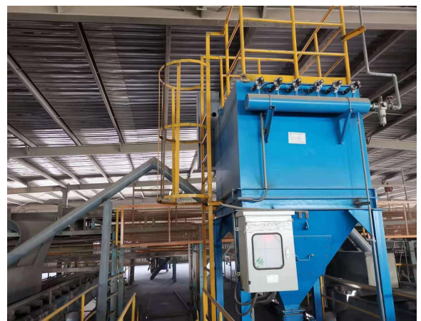
8#: 制成车间二线出磨斜槽除尘系统
