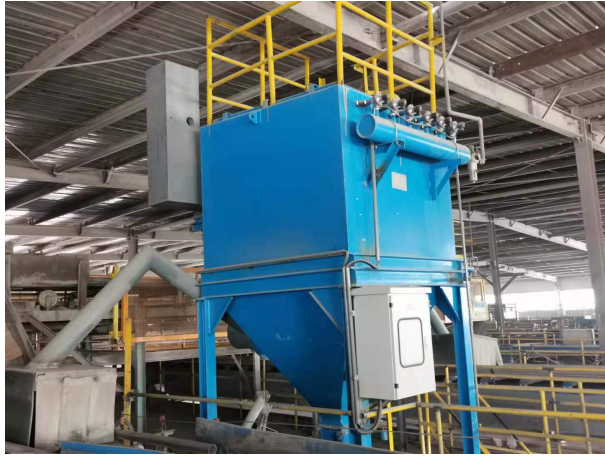
21#: 发运二线 1 号装车机转角除尘系统
