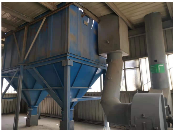
13#: 发运二线 2 号钢平台皮带除尘系统
