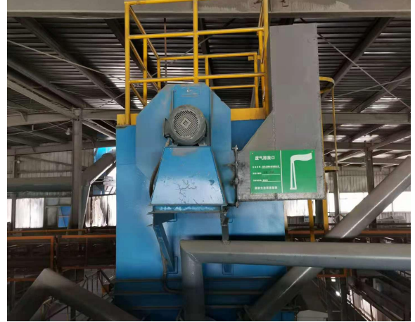
22#: 发运二线 2 号装车机转角除尘系统
