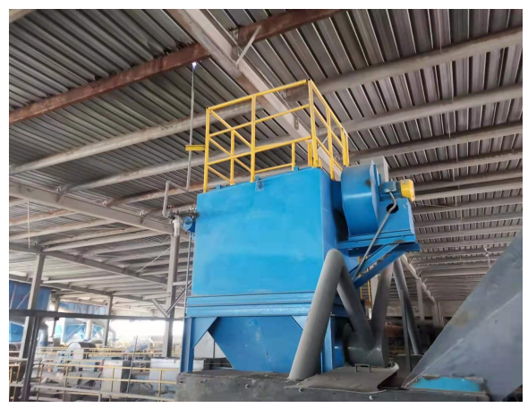
24#: 发运二线 4 号装车机转角除尘系统
