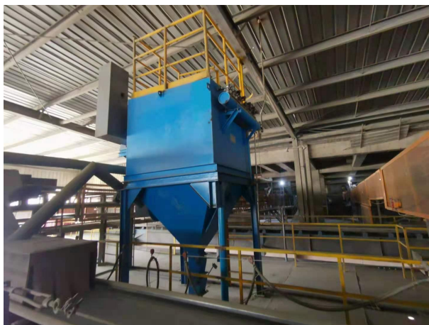
19#: 发运一线 3 号装车机转角除尘系统
