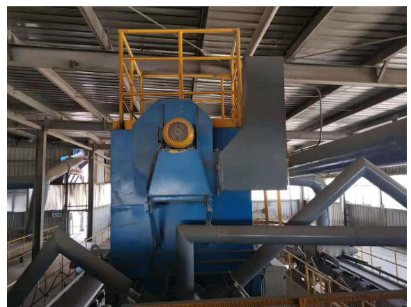
20#: 发运一线 4 号装车机转角除尘系统
