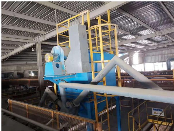
17#: 发运一线 1 号装车机转角除尘系统
