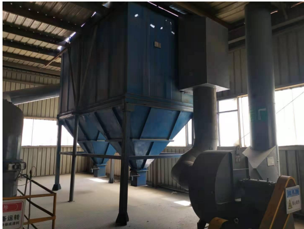
23#: 发运二线 3 号装车机转角除尘系统
