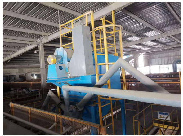
18#: 发运一线 2 号装车机转角除尘系统
