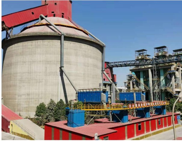
4#: 烧成二线熟料库库顶 01 除尘系统 5#: 烧成二线熟料库库顶 02 除尘系统
