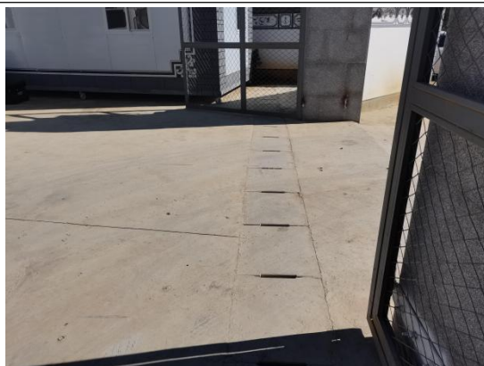
项目四周雨水沟
