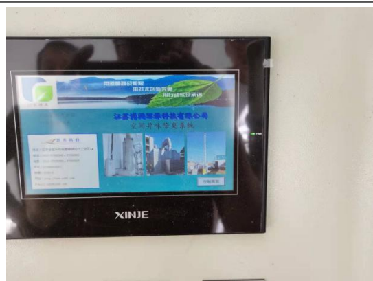
喷淋除臭系统
