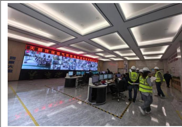
集控中心控制厅
